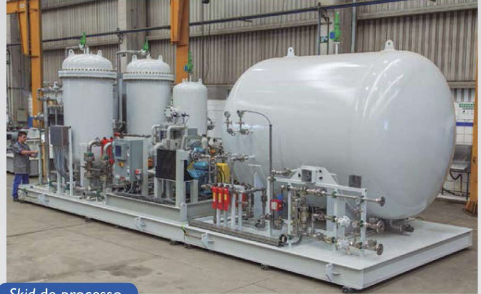
Skid de processo
